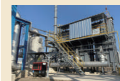
RTO排ガス処理設備
