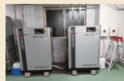
低振動タイプのコンプレッサーの導入
